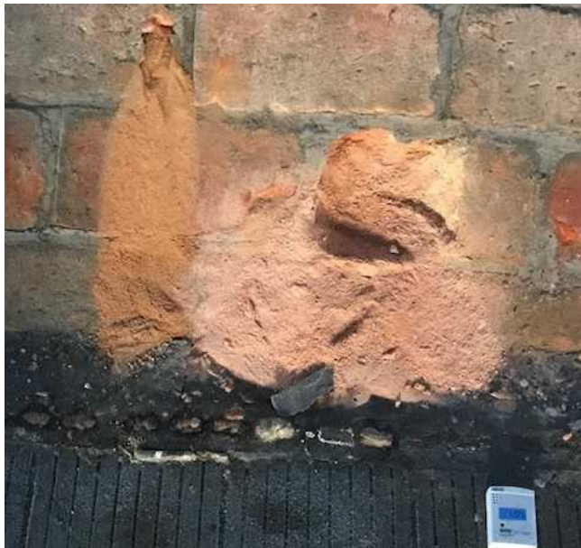
窯上部の塩類風化の様子 （風化が進み煉瓦が粉状になっている）
