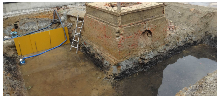
煉瓦解体時に確認された地下自由水
